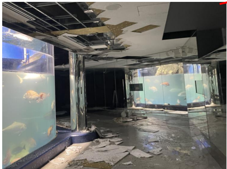
のと海遊回廊天井落下
