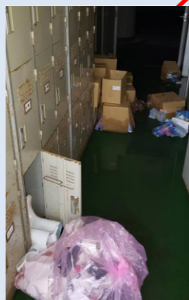
浸水した事務室廊下 (段ボールが濡れている)
